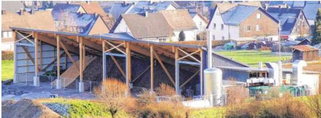
Bioenergiedorf Wallen: Heizanlage mit Lager für Holzhackschnitzel und Blockheizkraftwerk.
