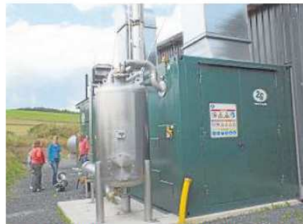
Das Satelliten-Blockheizkraftwerk sorgt für die Verbrennung des Biogases.
