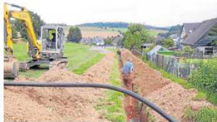
In Wallen wurde ein komplettes Nahwärme-Netz erstellt. Dazu mussten neue Leitungen verlegt werden.
