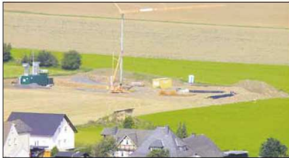
Die Bauarbeiten begannen im Juli 2011. Auf einer Grundfläche von 800 m 2 entstand die Heizzentrale mit Hackschnitzellager und Heizhaus.
